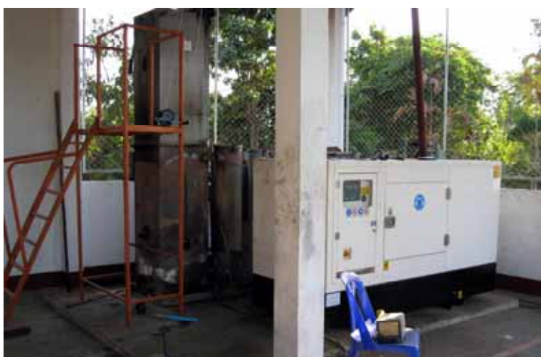
図 2-2-12 バイオガスと軽油との混焼によるディーゼル発電の実証実験 （手前がディーゼル発電機，奥がガス化装置）
