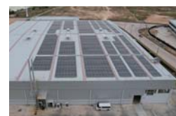
No.12 丸紅(株) … 金属リサイクル・自動車部品工場への0.9MW屋根置き太陽光発電システム導入による電力供給事業
