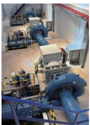
No.15 富士・フォイトハイドロ(株) … 西スマトラ州における6MW小水力発電プロジェクト
