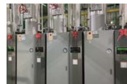
No.7 DIC(株) … 化学工場への高効率貫流ボイラの導入
