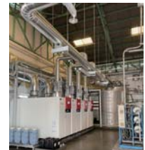
No.7 大阪ガス(株) 衣料品製造工場への高効率貫流ボイラの導入
