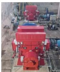
No.14 富士・フォイトハイドロ(株) カライ7小水力発電所における発電システム能力改善プロジェクト
