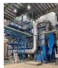
No.6 第一実業(株) 化学工場へのバイオマスボイラーの導入
