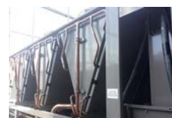
No.10 日立ジョンソンコントロールズ空調(株) オフィスへの空冷チラーの導入
