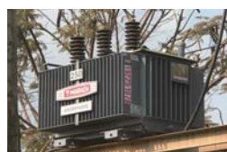
No.6 裕幸計装(株) 配電網へのアモルファス高効率変圧器の導入
