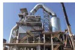
No.7 (株)グローバルエンジニアリング セメント工場への8.8MW廃熱 回収発電システムの導入
