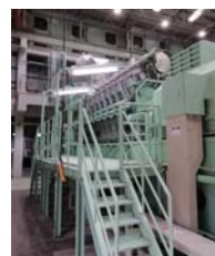
No.8 関西電力(株) 繊維工場へのガスコージェネ レーションシステム及び吸収式 冷凍機の導入
