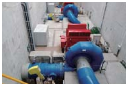
No.4 (株)トーヨーエネルギーファーム 北スマトラ州10MW小水力発電プロジェクト
