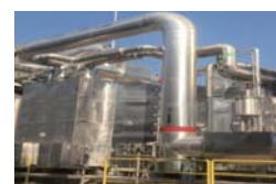
No.8 日鉄エンジニアリング(株) 繊維工場におけるコージェネレーション設備への排ガス熱交換器の導入による高効率化
