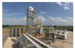
No.15-9 籾殻ガス化コージェネレーションシステム
