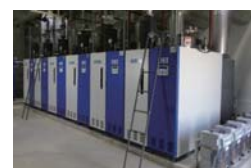
No.17 即席麺工場への高効率貫流ボイラの導入(設置されたボイラ)
