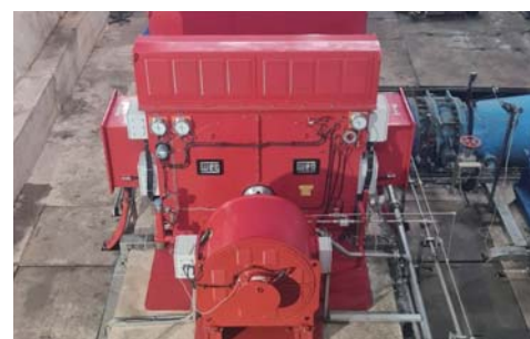
50 小水力発電設備の導入(インドネシア)
