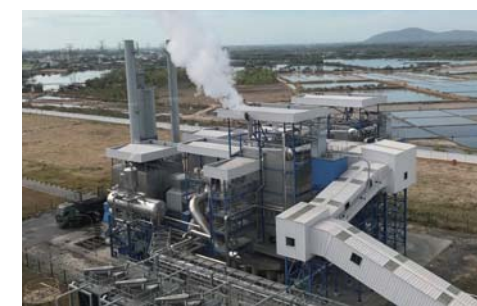
54 インスタントラーメン製造工場へのバイオマスボイラーの導入(ベトナム)
