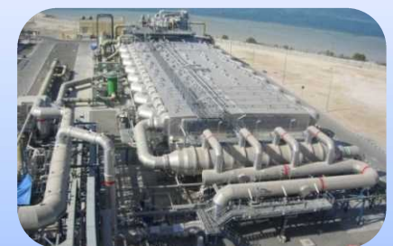
海水淡水化プラント
