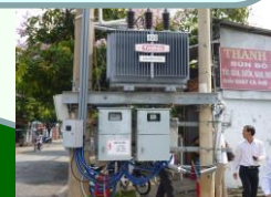
高効率変圧器
