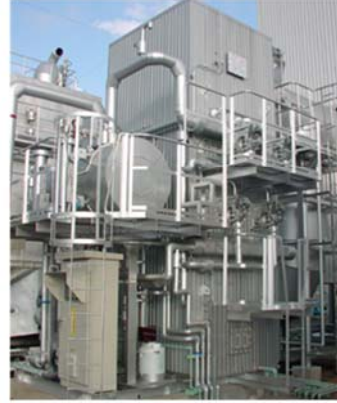
(排ガスボイラ外観)
