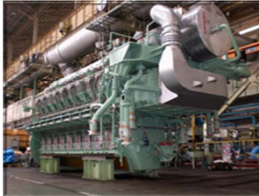
(ガスエンジン外観)
