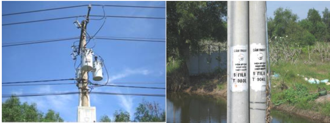
図 4-4 : タムタン通りにある 22kV 線
