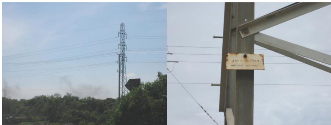
図 4-6 : 110kV 2 回線ドクフェ-ドクホア間送電線
