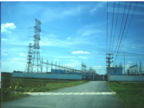
図 4-9 : 220kV クチ変電所
