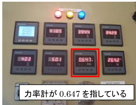
図 18 フラ島の発電機制御盤（力率計が故障）
