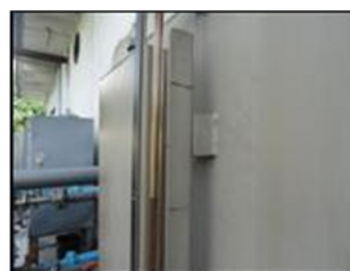
小出燃料タンクレベル計
