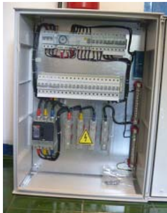
図 30 新規導入中の大型 DB 内部
