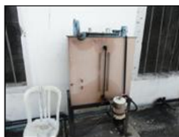
小出燃料タンク
