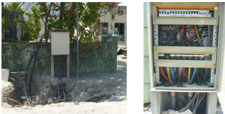
図 14 島内に施設されている DB 外観 (左) と内部 (右)
