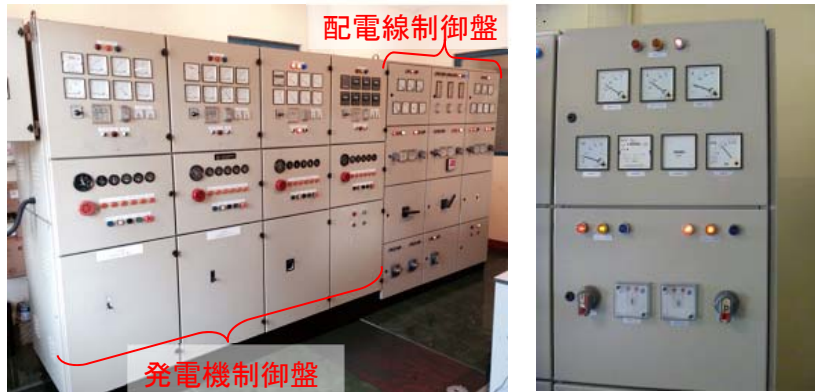
図 13 フラ島発電所 配電線制御盤
