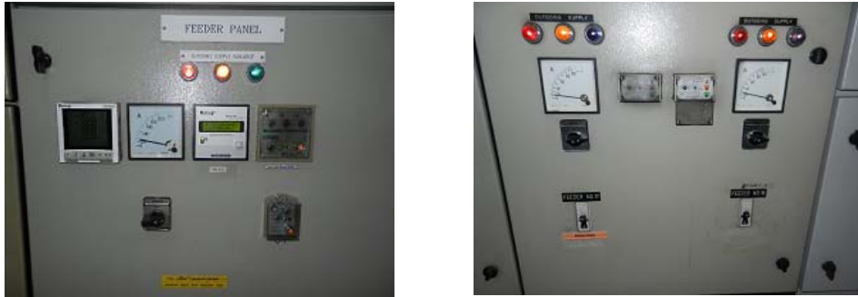
図 17 クダフラ島発電所の配電線制御盤
