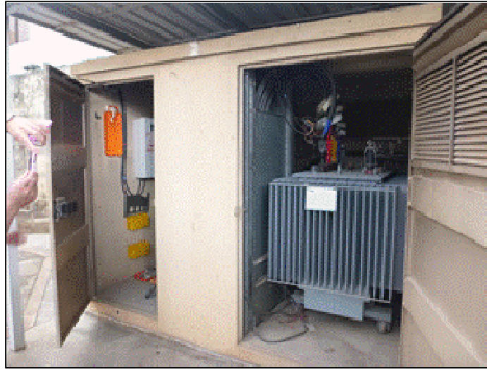
図 12. チャンカーモン取水場の変圧器
