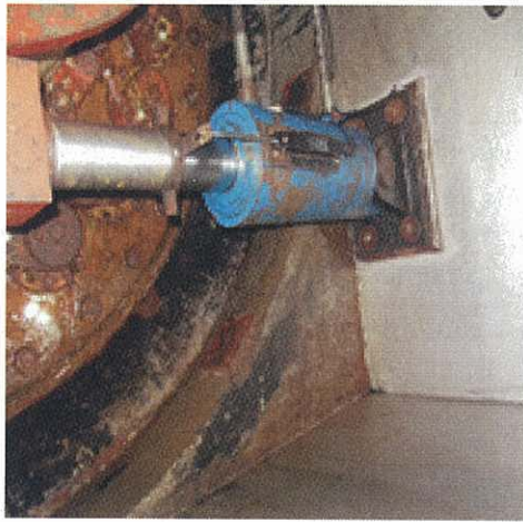
写真-4.3 機器発錆状況 出所:調査団撮影
