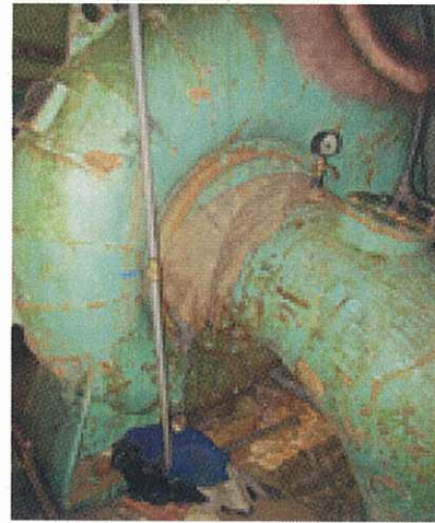
写真-4.4 機器発錆状況 出所:調査団撮影
