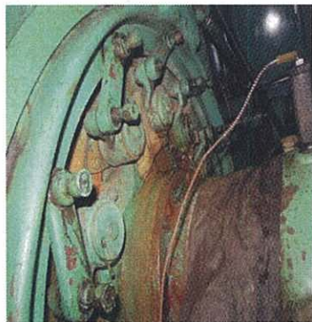
写真-4.1 主軸封水部からの漏水
