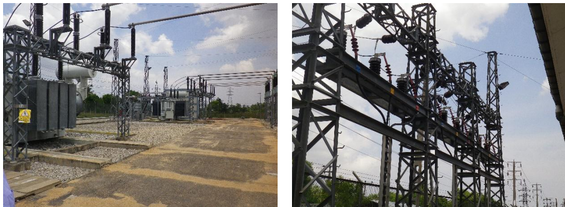
図 2-4. 31.5MVA 降圧器(左)と給電線(右)
