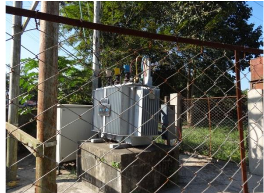
写真 4.1.2-3 建設予定地周辺の変圧設備 (電圧 11k-400V, 容量 500kVA)
