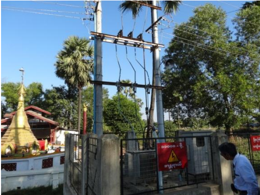
写真 4.1.2-2 建設予定地周辺の変圧設備 (電圧 11k-400/230V, 容量 315kVA)
