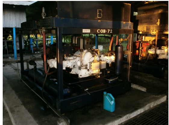
CNG 専用のコンプレッサー
