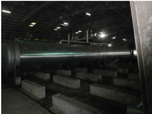
FFB蒸煮設備
