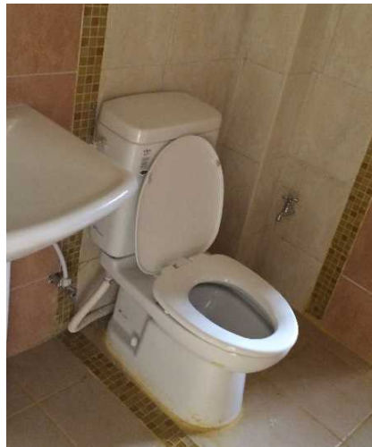
図 2-5 設置済みの超々節水トイレ
