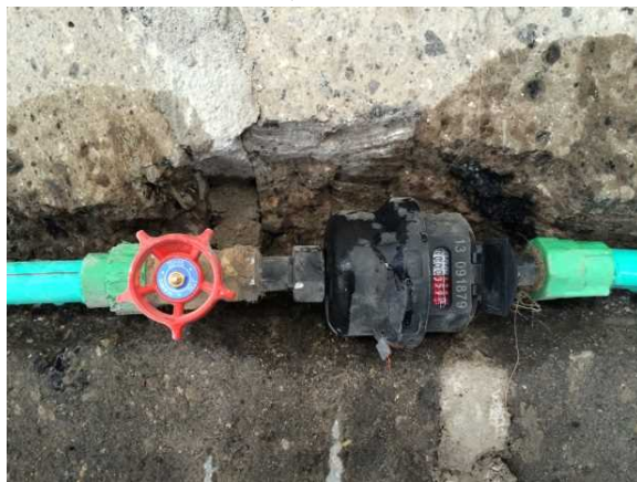
各戸の水道メーター
