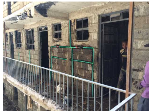
各戸における給水配管
