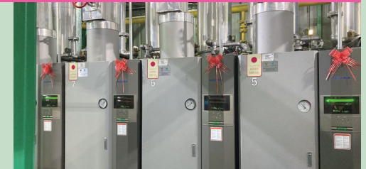
貫流ボイラー（インドネシア）DIC
