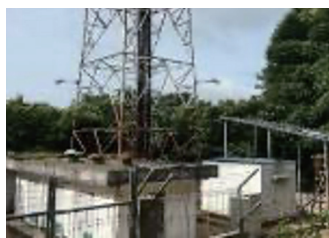
携帯電話基地局へのトライ ブリッド技術導入（KDDI）
