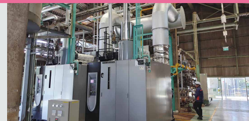
ボイラー（タイ）関西電力
