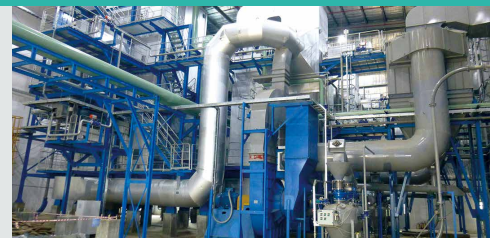
バイオマスボイラー（ベトナム）第一実業
