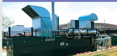
メタンガス回収発電（メキシコ）NTT データ経営研究所
