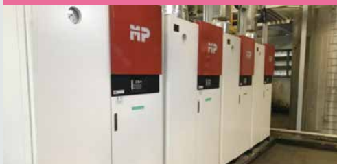
貫流ボイラー（タイ）大阪ガス
