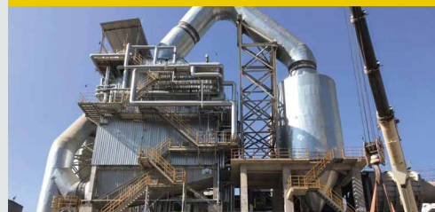
廃熱回収発電（ミャンマー）グローバルエンジニアリング
