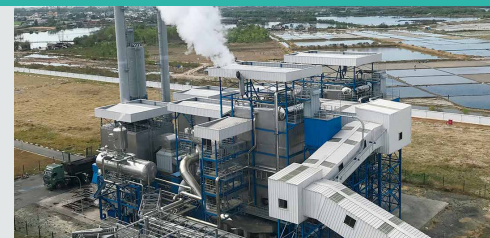
バイオマスボイラー（ベトナム）丸紅
