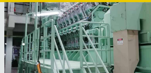
ガスコジェネレーション・冷凍機（タイ）関西電力
