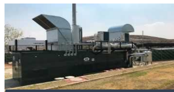
メタンガス回収発電 (NTTデータ経営研究所)
