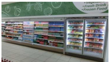
コンビニ省エネ (ロゾン) 省エネ設備：パナソニック製
