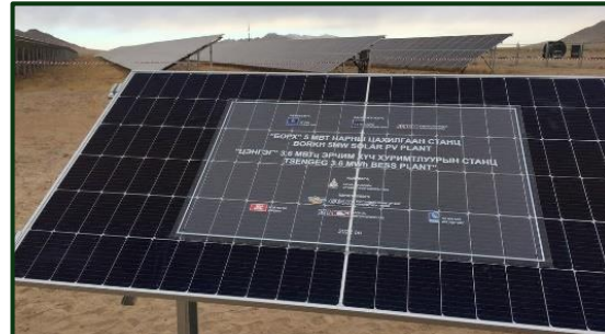
再エネ拡大プロジェクト（モンゴル）
