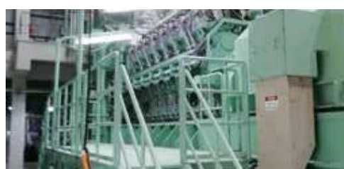
ガスコージェネレーション・冷凍機 (タイ) 関西電力
