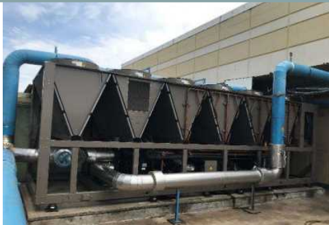
設置された省エネ型チラー
