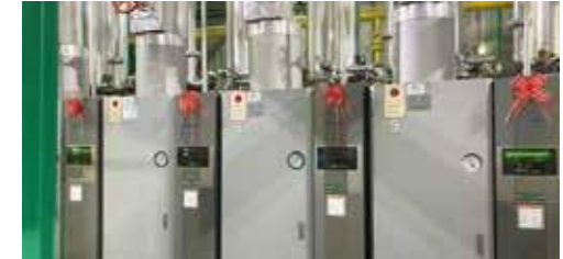
貫流ボイラー (インドネシア) DIC
