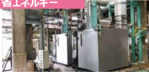
ボイラー・冷凍機・太陽光発電 (タイ) 関西電力
