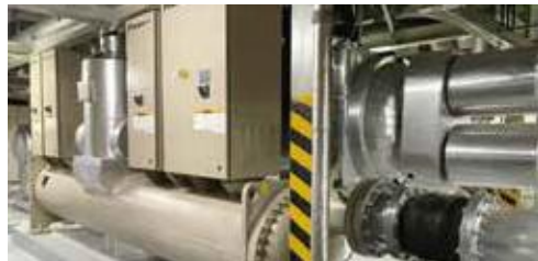
チラー・空調機・太陽光発電 (インドネシア) 裕幸計装
