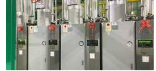
貫流ボイラー (インドネシア) DIC
