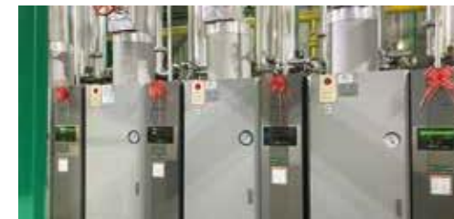
貫流ボイラー (インドネシア) DIC
