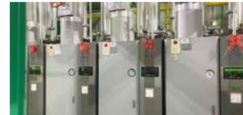
貫流ボイラー (インドネシア) DIC
