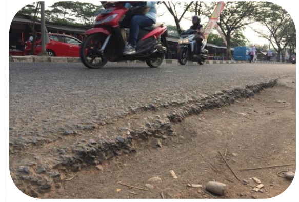
写真2 切削オーバーレイ工法の必要な車道
