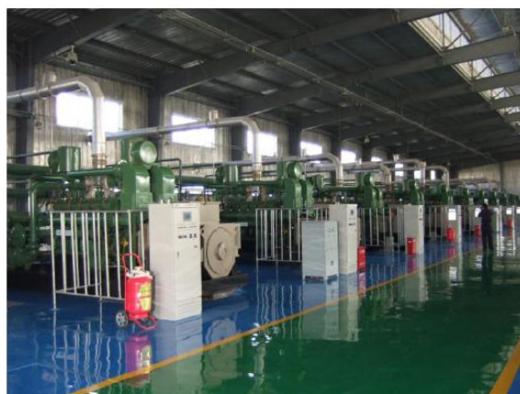
ガスエンジン発電機
