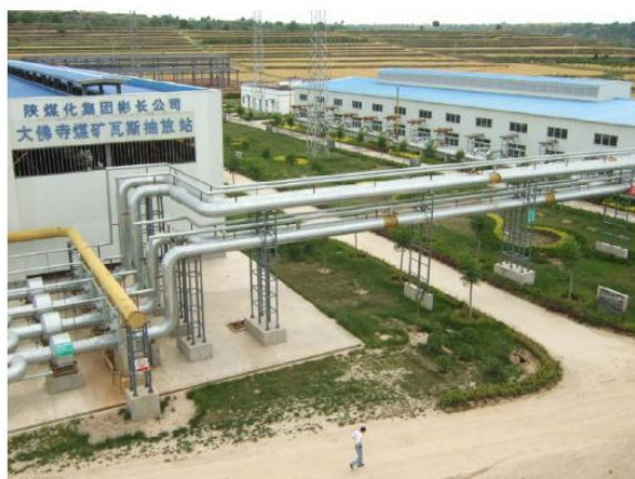
ガス抽出センターと低濃度メタンガス発電所
