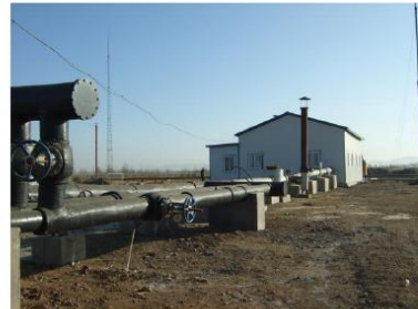
地表の抽出センター、中にブローアが設置されている
