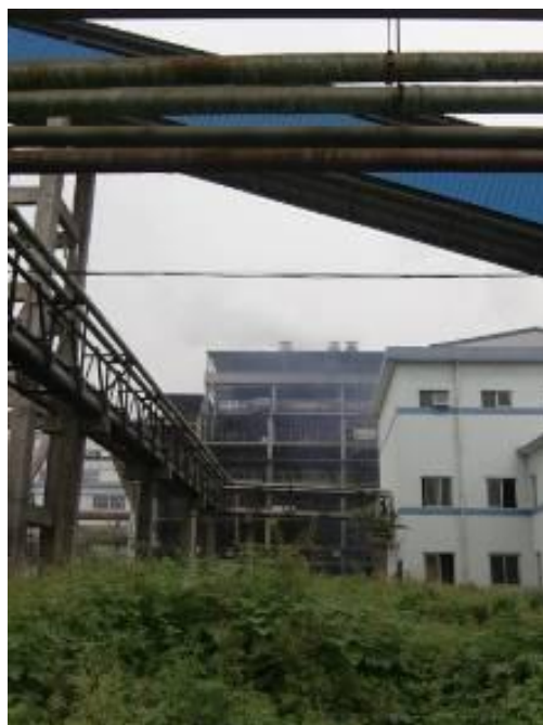
図 4 既存の余熱ボイラと大気放散の様子 (2010 年 9 月撮影)
