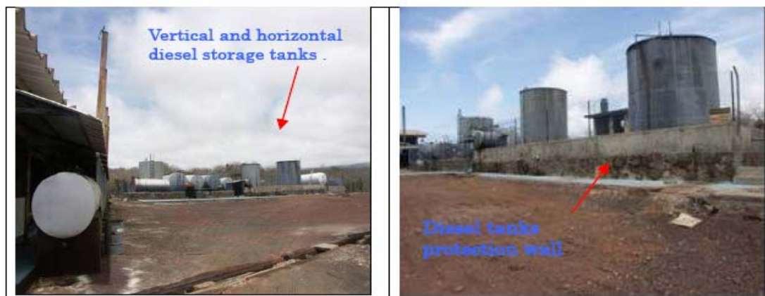
図 1-8 : プエルトアヨラ市の発電所における備蓄システム
