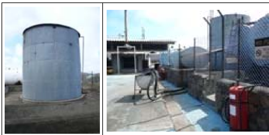
図 6-5 : サンタクルス島の発電所写真
