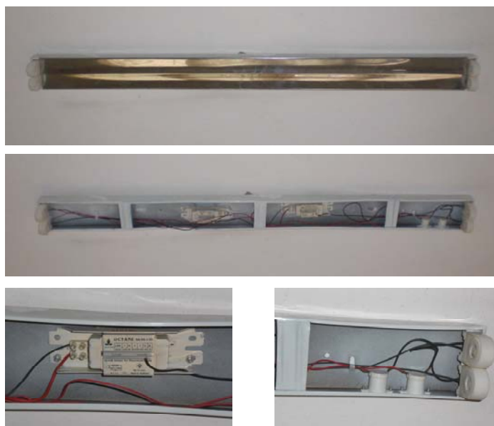
写真 1-8 改造前の蛍光灯器具
