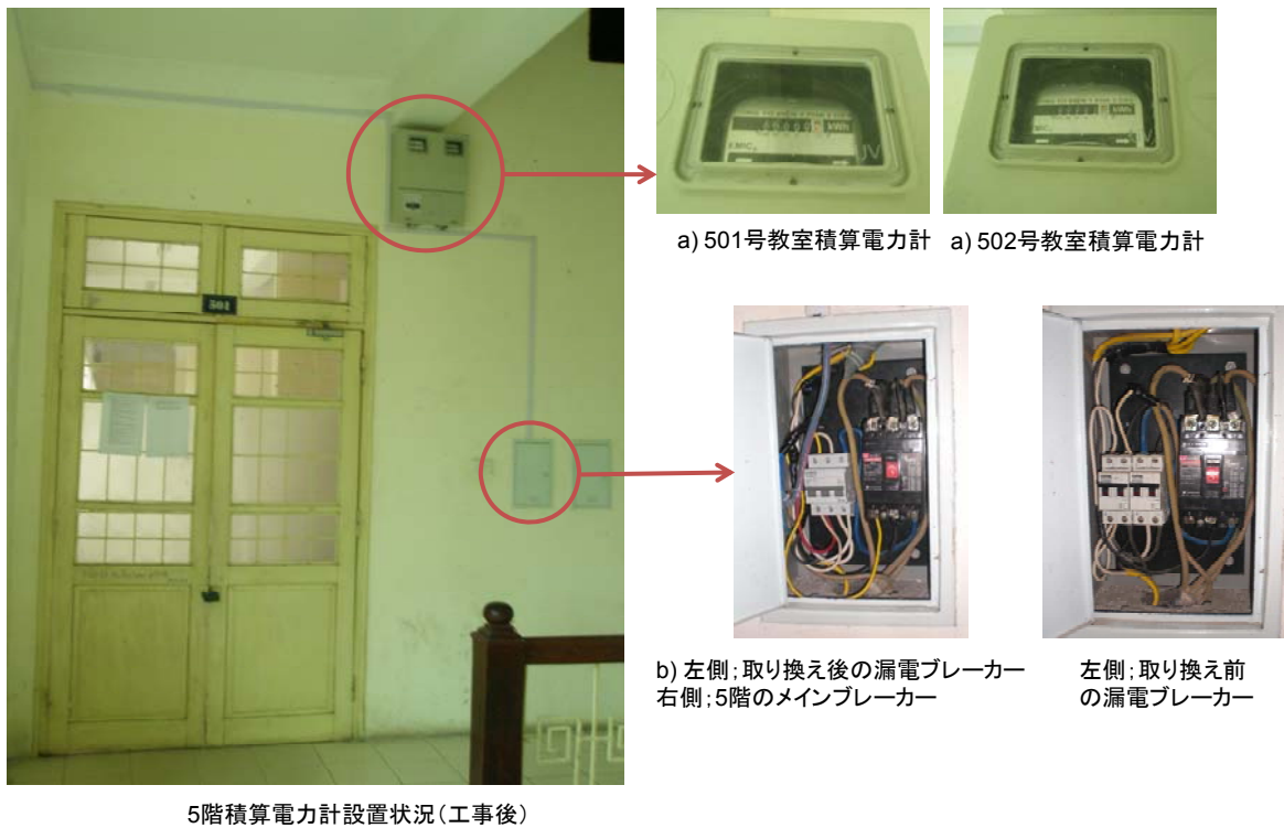
写真 1-10 積算電力計の設置状況
