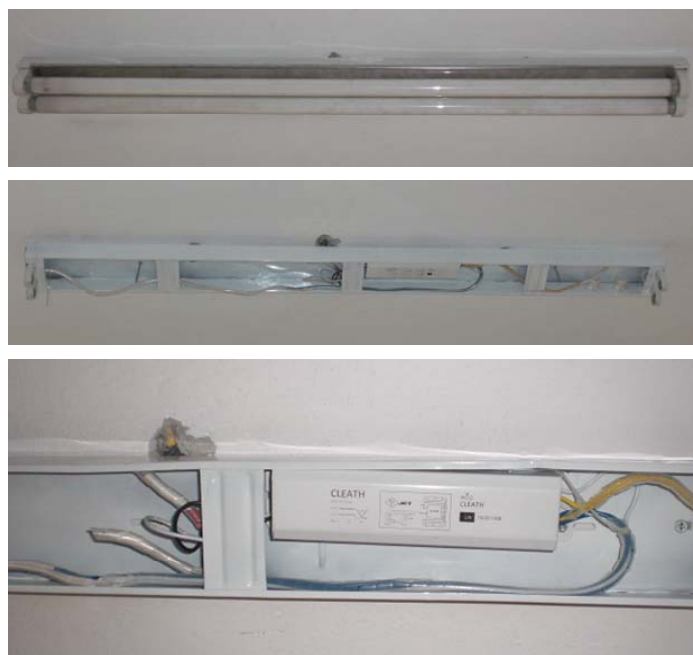
写真 1-9 電子安定器設置後の蛍光灯器具
