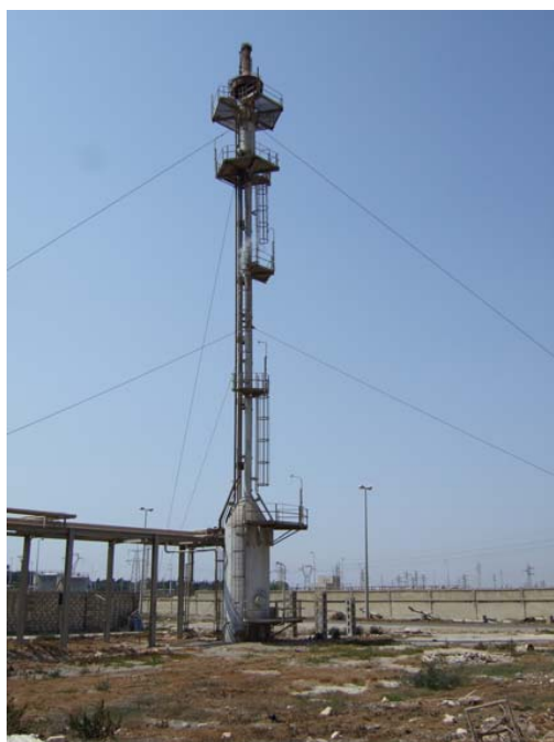
パージガス放出塔
