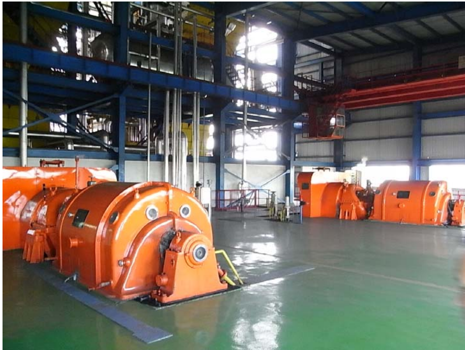
写真 3-1 蒸気タービン発電機
