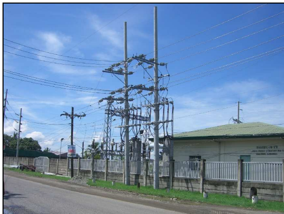
写真 3-10 現地配電会社変電所
