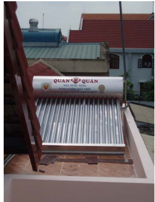
住宅に設置された太陽熱温水器
