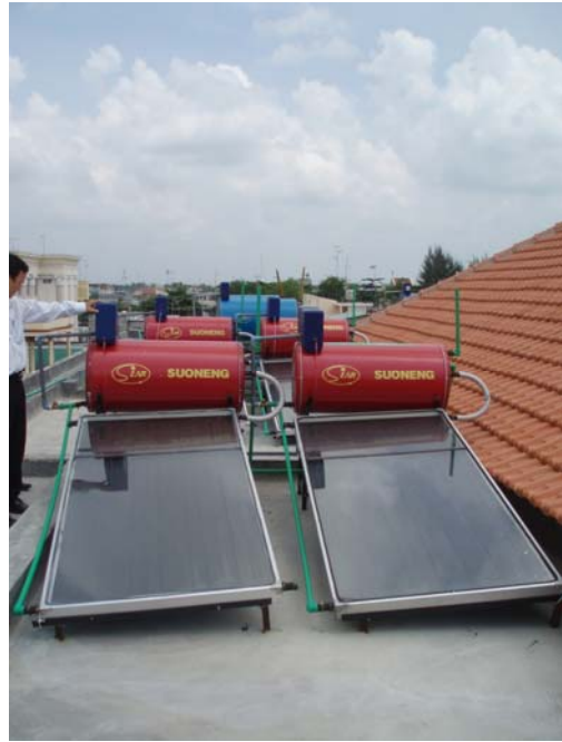
幼稚園の屋上に設置された太陽熱温水器
