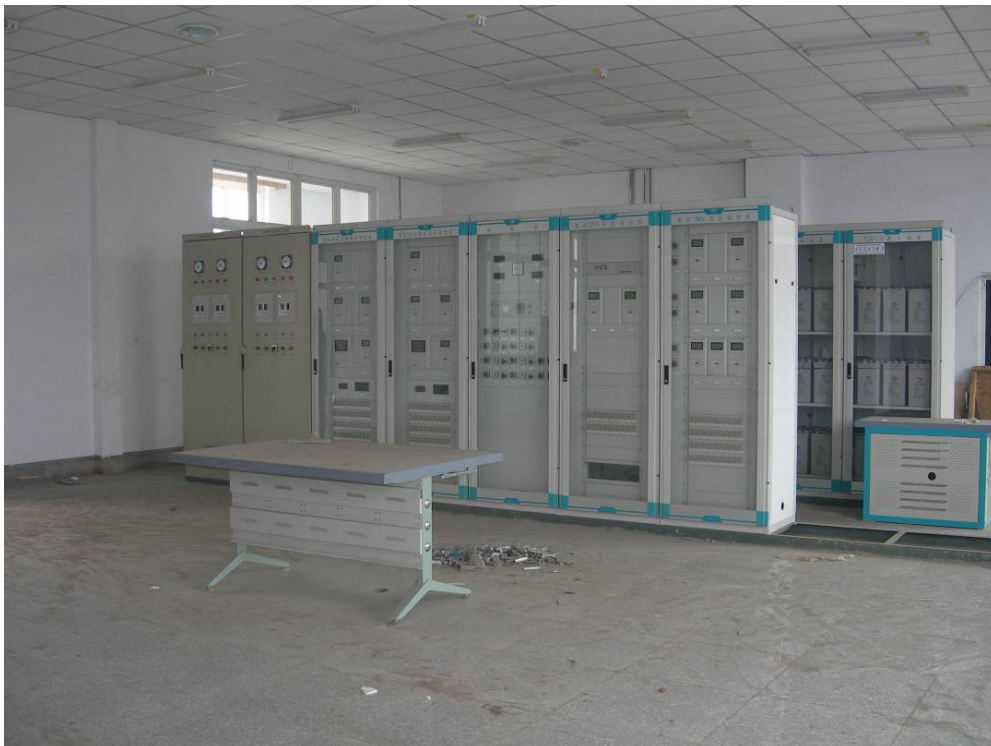
コントロール室
