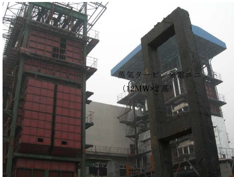
COG ボイラ (75t/h×2 基)
