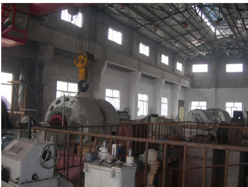
蒸気タービン発電ユニット (12MW×2 基)
