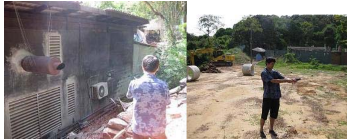
ディーゼル発電機 導入予定サイト Holiday Inn Resort Phi Phi Island 施設内の大気測定
