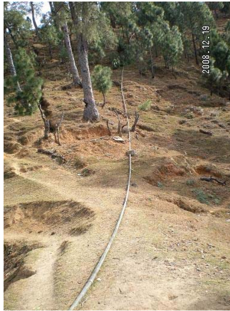
図 14-4 Hill でみかけた給水用配管
