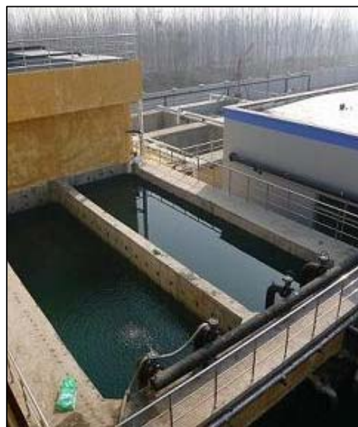
図 2-6 嫌気発酵設備（左）および汚水の好気発酵設備（右）
