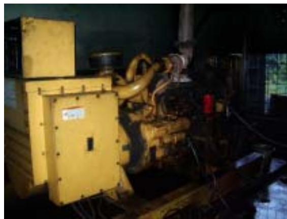
写真 3-2 ブリッカビル発電所のディーゼル発電機
