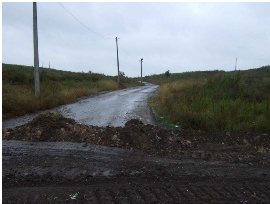
写真 2.4-3 ベラヤツェルコフ埋立処分場の現状(3)
