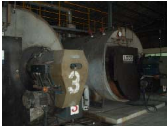
C 重油焚きボイラー(非常用)
