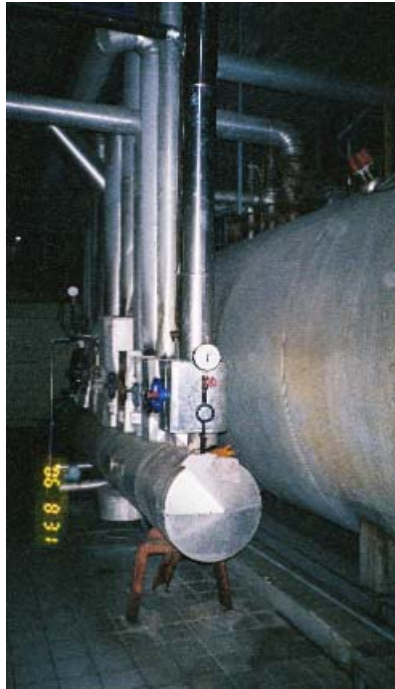
蒸気ヘッダー廻り
