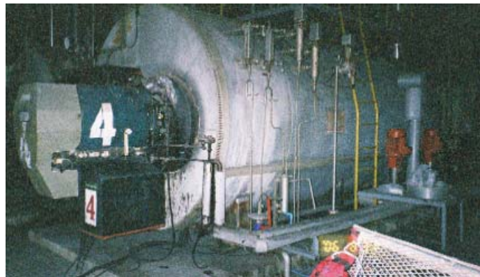
C 重油焚きボイラー(非常用)
