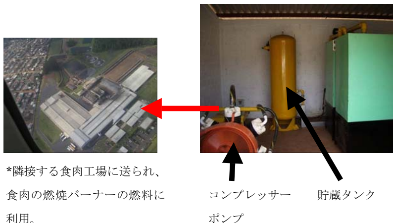
図表 4-17 メタンガスの回収装置（貯蔵タンク）、搬送ポンプ
