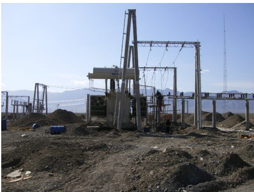
図 4.4 管理事務所に隣接する変電所（2）
