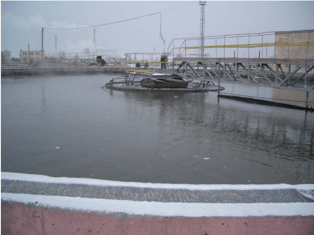
写真 2-1 ボルトニッチ排水処理場（一次沈殿槽）
