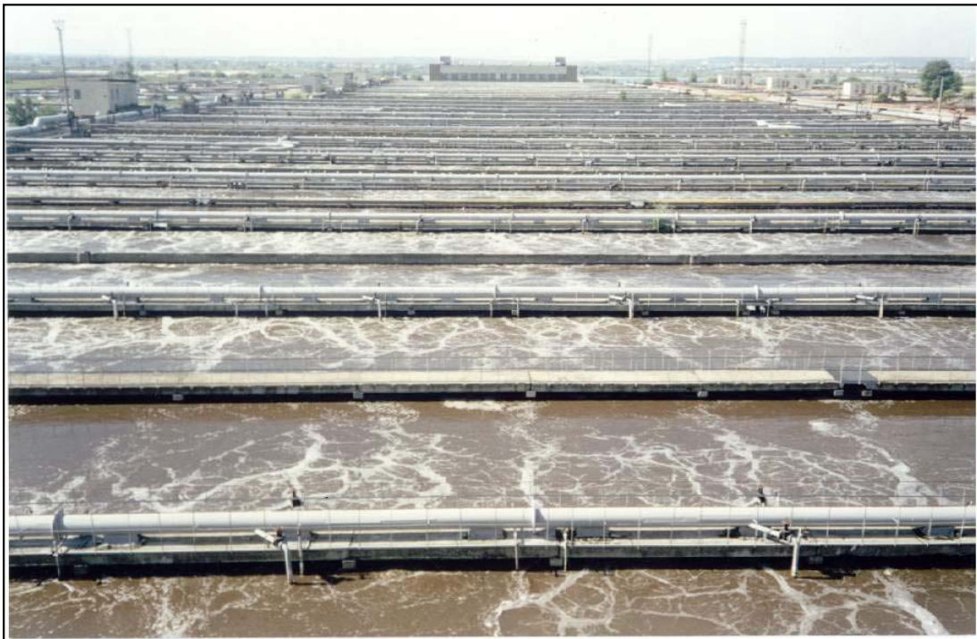
写真 2-4 ボルトニッチ排水処理場（曝気槽）
