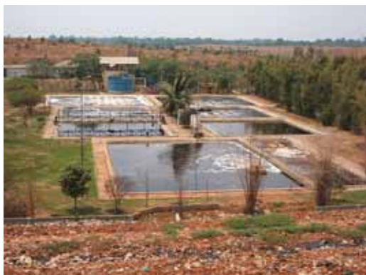
図 4-7 浸出水処理施設
