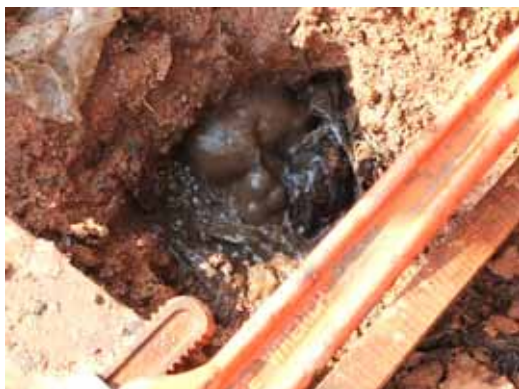
図 4-16 ボーリング孔からの貯留水の噴出し
