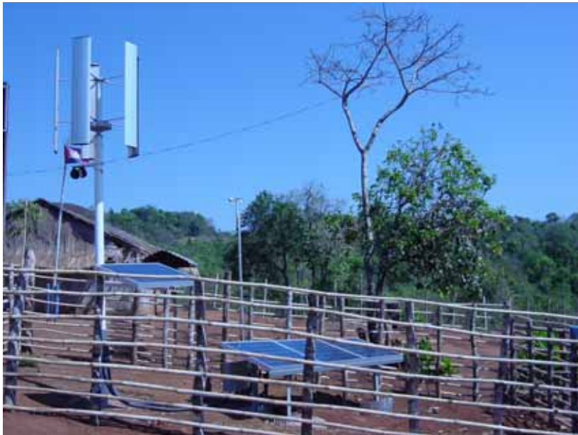
写真 3.2.1 ハイブリッド発電システム設置後
