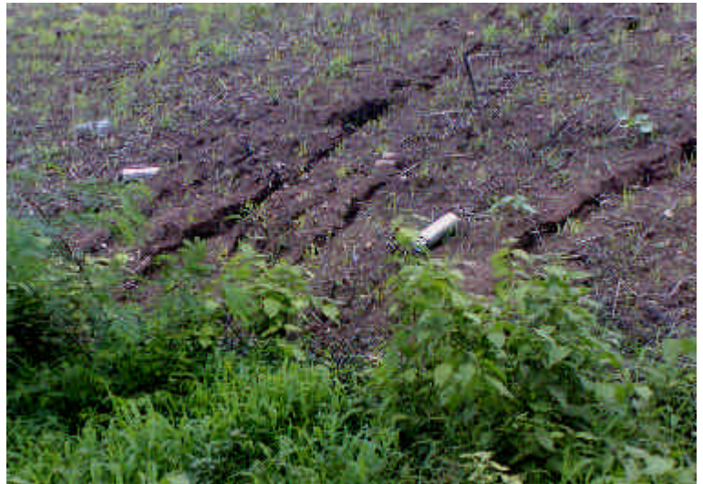
写真 6-2 雨期の驟雨により発生した川
